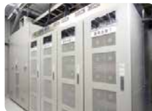
回生電力貯蔵装置
