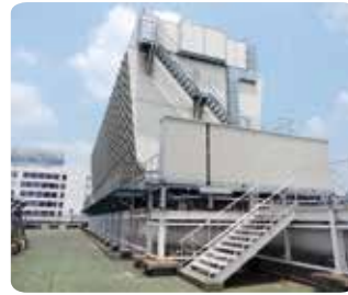
西池袋熱供給施設
