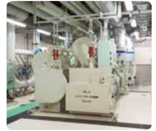
錦糸町熱供給施設
