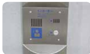
非常用インターホン
