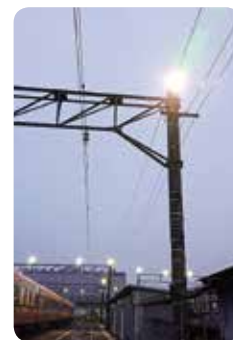
南栗橋車両管区 春日部支所構内照明器具
